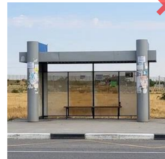
Отсутствие своевременной очистки от рекламы. Массивная конструкция.
